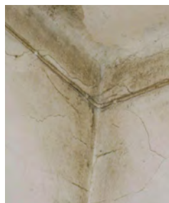
PAREDE COM SINAIS DE HUMIDADE
