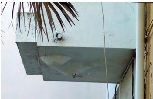
DESPRENDIMENTO E FALTA DE ADERÊNCIA
