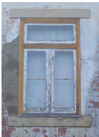
FALTA DE MANUTENÇÃO
