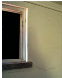
FISSURA NA PAREDE
