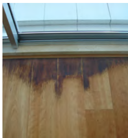
PARQUETE COM PRESENÇA DE HUMIDADE
