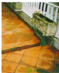
OBSTRUÇÃO DE ÁGUAS
