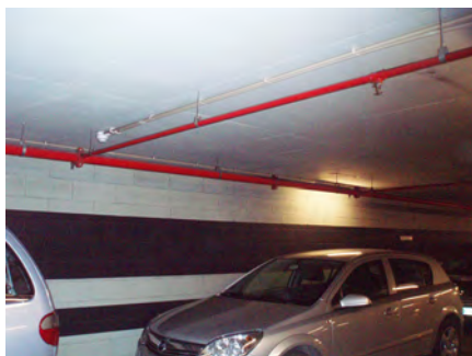
REDE DE SPRINKLERS
