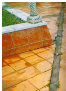
IRREGULARIDADES NO PAVIMENTO
