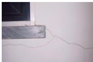
FISSURAS NO INTERIOR DA HABITAÇÃO
