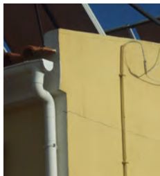
OBSTRUÇÃO DE CALEIRAS
