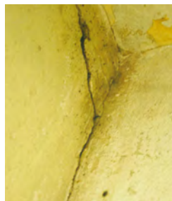
FALTA DE REPARAÇÃO DO ESTUQUE
