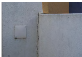
FENDA NO EXTERIOR DA HABITAÇÃO
